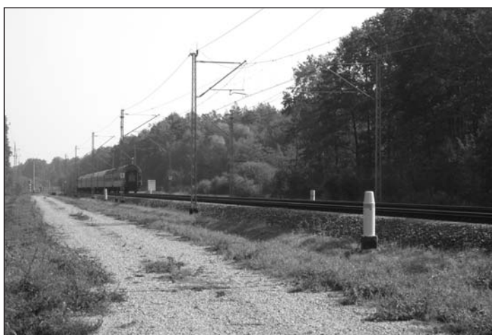
Rys. 4. Urządzenia UOZ-1 zainstalowane w punkcie odstrasżania Woźbin koło stacji Mrozy na odcinku linii kolejowej E20 pomiędzy Mińskiem a Siedlcami, bezpośrednio graniczącym z rezerwatem przyrody „Stawy Broszkowskie”
