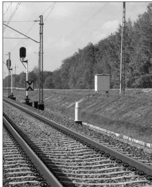
Rys. 1. Urządzenie UOZ-1 zainstalowane przy torze kolejowym i znajdujący się obok niego kontener samoczynnej blokady liniowej
